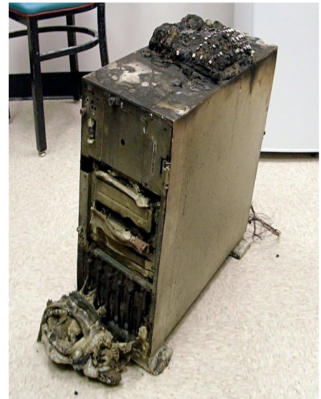
Zerstörter Backup-Server durch Brand
